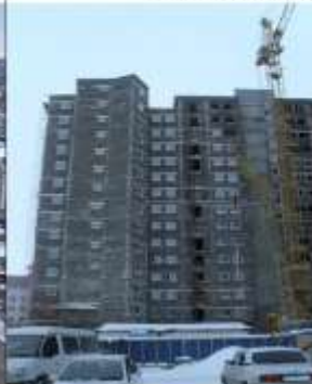
Nižnevartovsk, Sibir, višesekcijski stambeni objekat površine > 20.000 m 2 - Simprolit fasadni i pregradni blokovi, SUP ploče i Simprolit monolit
